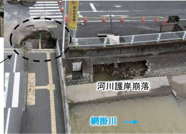
写真③ 【下流側護岸の被災状況】
