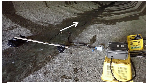
読み取りアンテナの設置状況
