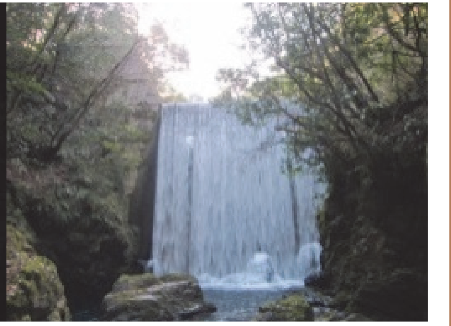
5. 平野川第3砂防堰堤 完成：昭和43年10月 堤高：12.50m
