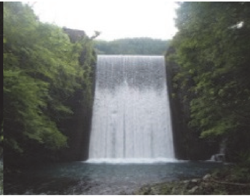
25. 平野川第4砂防堰堤 完成：昭和47年10月 堤高：20.00m
