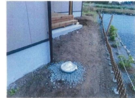
雨水浸透ます
