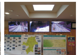
道の駅情報提供設備
