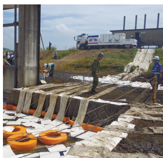
TEC-FORCE隊の派遣① 令和元年8月 前線に伴う大雨 （佐賀県杵島郡大町町）
