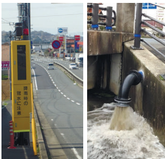
冠水対策（情報板、ポンプ設置） （国道10号 豊前市）
