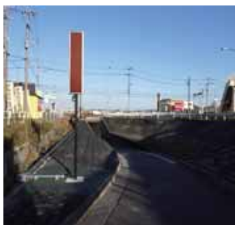
冠水対策（情報板） （国道10号 小倉南区）
