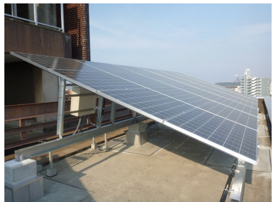
■ 太陽光発電パネルの設置事例 （大分地方合同庁舎2013年度完成）
