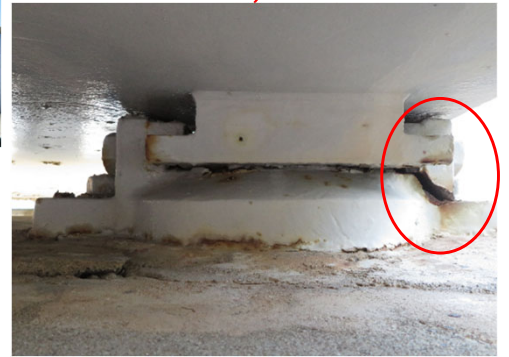
③【支承の損傷】 (P6橋脚上のサイドブロック破断)
