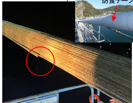
②【主ケーブルの破断】 (防食テープを外し調査実施)
