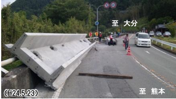
▲ コンクリート桁落下事故発生状況 (写真②)
