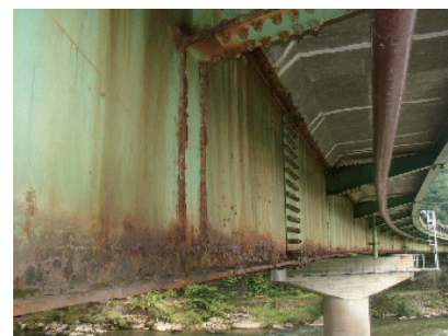
鋼材の腐食に伴う強度の低下
