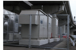
《非常用発電機》
