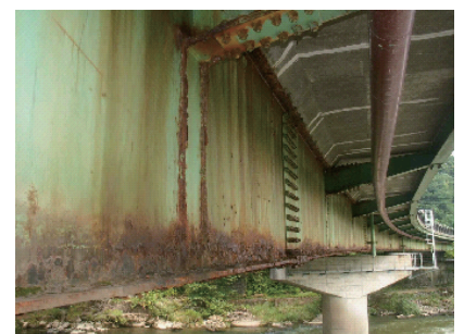
鋼材の腐食に伴う強度の低下 (データは令和7年3月時点のものです)
