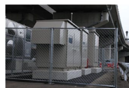
《非常用発電機》
