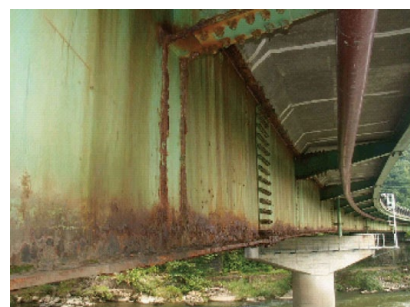
鋼材の腐食に伴う強度の低下
