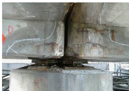
凍結防止剤を含む漏水による 支承の劣化(塩害)
