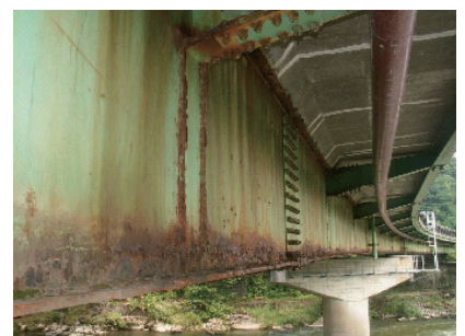
鋼材の腐食に伴う強度の低下
