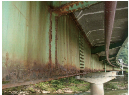
鋼材の腐食に伴う強度の低下
