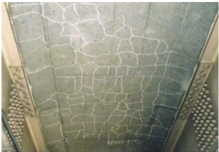
疲労による コンクリート床版のひび割れ
