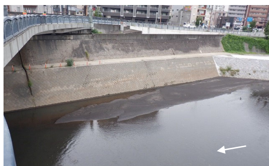
写真－2.1.4 長六橋上流：ヨナ堆積状況 (右岸 11k800 付近)
