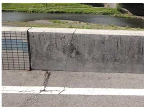
写真－2.3.2 特殊堤の亀裂 (右岸 12k200 付近)
