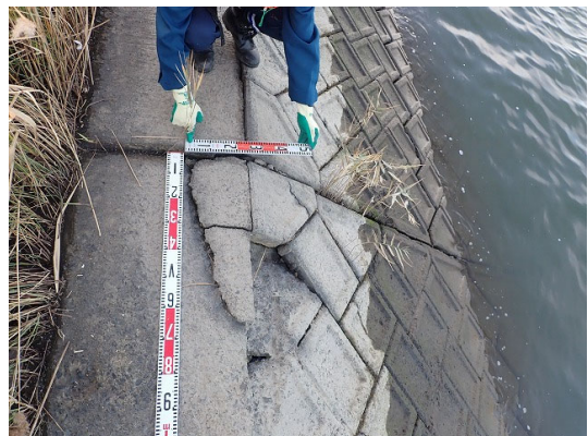
写真－2.2.4 低水護岸（ブロック張り）の破損 （左岸 1k720 付近）
