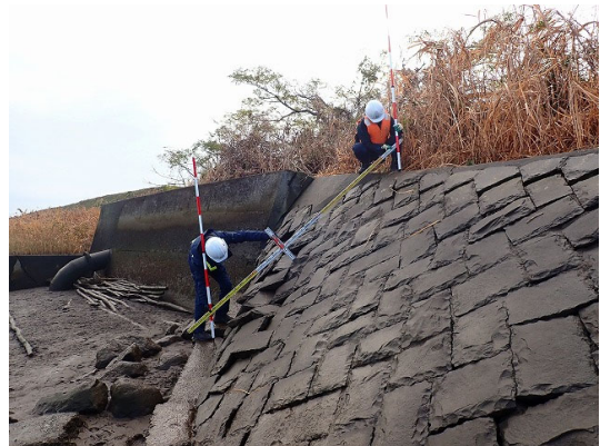
写真－2.2.2 低水護岸（石積み）の沈下 （左岸 1k400 付近）
