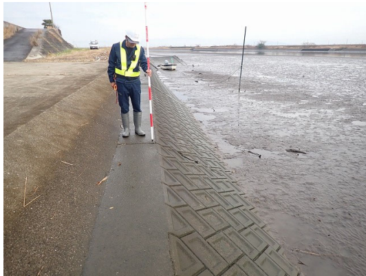
写真－2.2.1 低水護岸（ブロック張り）の亀裂 （右岸 1k000 付近）
