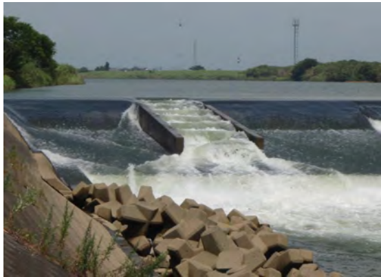
写真 4.2-7 杉島堰の魚道
