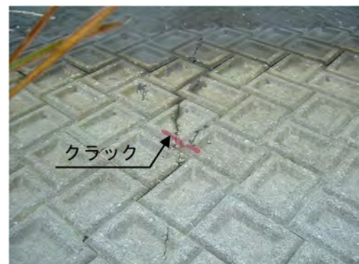
写真 2.1-10 護岸のクラック
