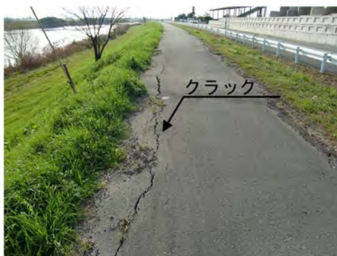
写真 2.1-9 堤防天端のクラック
