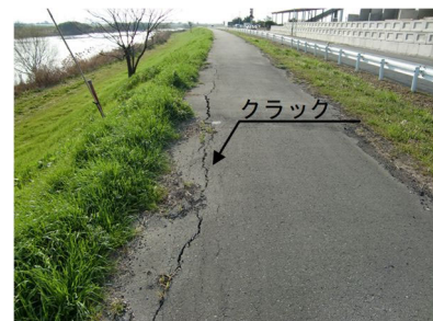
堤防天端のクラック
