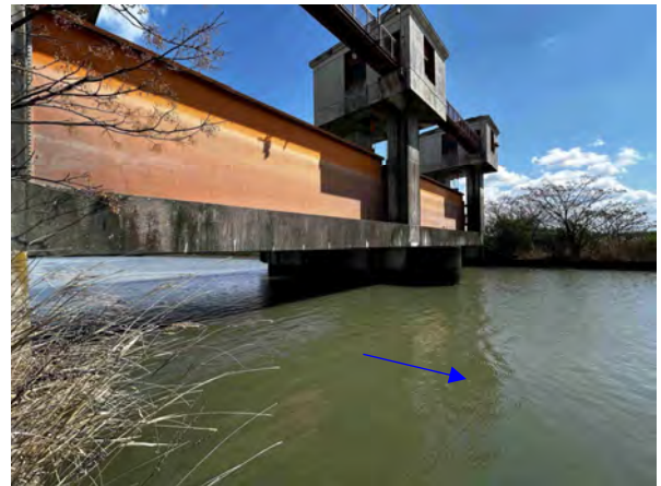
写真 2.3-34 浜戸川との合流部潤川水門
