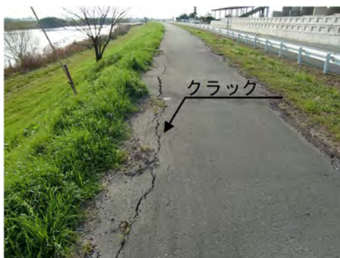
写真 2.1-9 堤防天端のクラック
