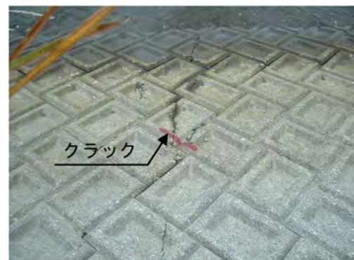
写真 2.1-10 護岸のクラック
