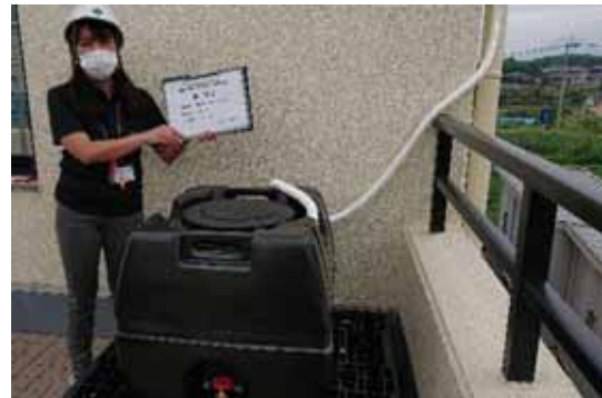
▲住居の2階に貯留タンクを設置
