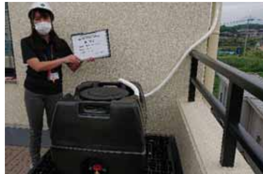
▲住居の2階に貯留タンクを設置
