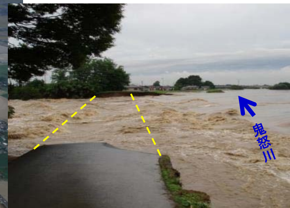
被災状況(拡大写真)
