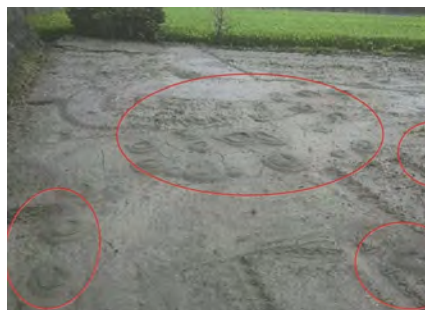
漏水による噴砂の例
