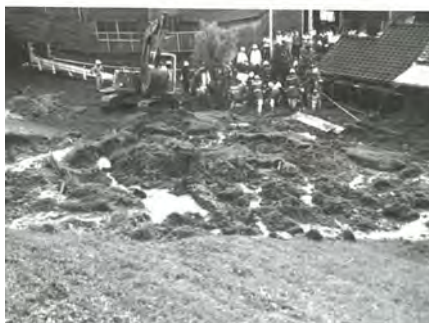
排水不良による法すべり
