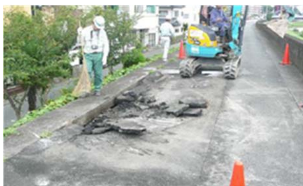
写真 2.1.11 特殊堤天端の変状
