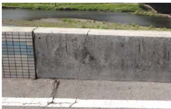
写真 2.1.10 特殊堤の亀裂図
