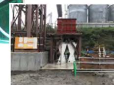
追加冷却設備
