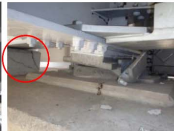
写真-6 支承の破損の状況
