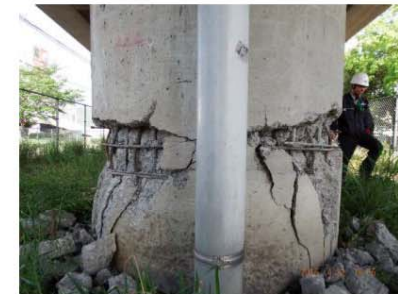
写真-7 段落し部の損傷
