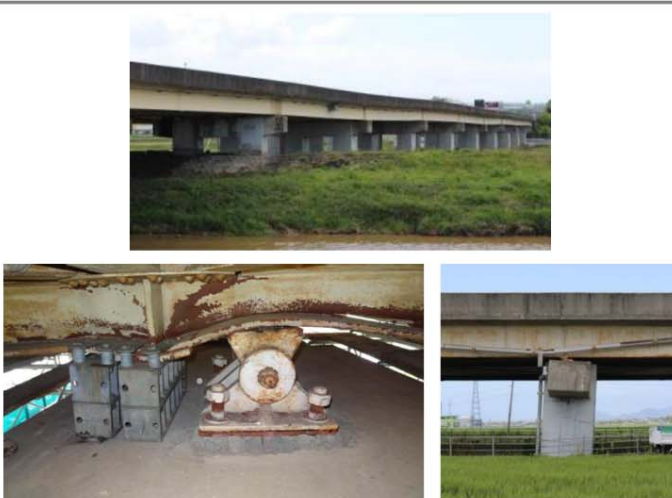
写真-1 支保部の損傷及び橋脚の傾斜 (九州自動車道・木山川橋)
