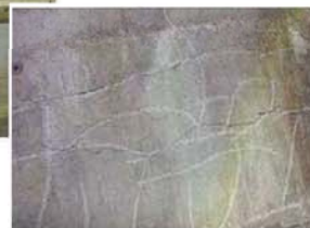
下部工のひび割れ
