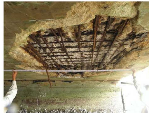
地方自治体管理 床版鉄筋露出
