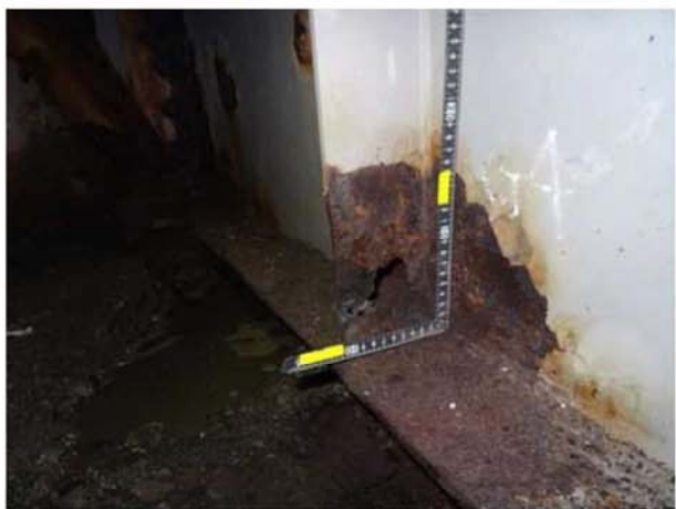
国管理 主桁腐食・欠損
