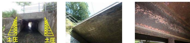
▲溝橋 変状項目
