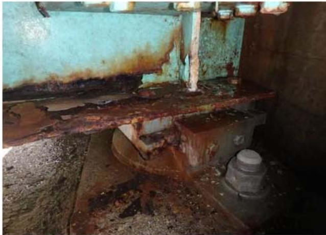
地方自治体管理 主桁腐食
