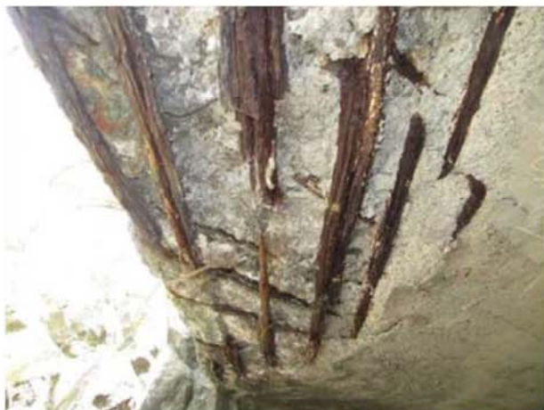
国管理 床版鉄筋露出 ※床版: 橋の裏側
