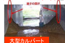
▲継手からの土砂流出
