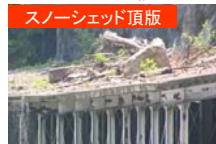
▲崩土等の堆積
