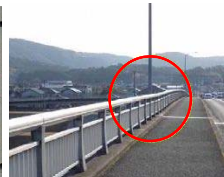
▲中央ヒンジ部の垂れ下がり
