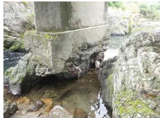
地方自治体管理 橋脚洗掘
