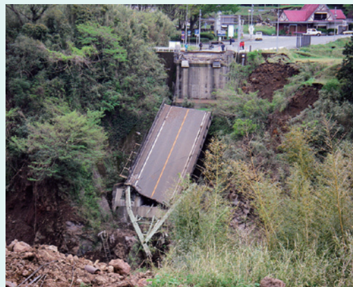
阿蘇大橋落橋—被災のシンボル
