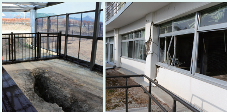
東海大学キャンパスの震災遺構(左:断層跡 右:壊れた教室の窓)
