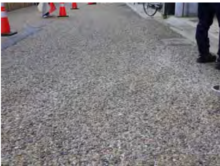
骨材飛散した脱色アスファルト舗装
