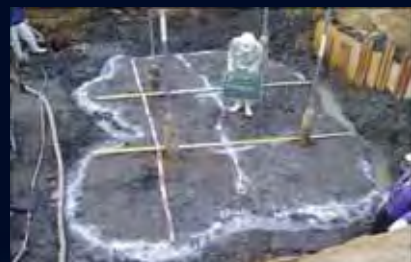
固結状況開削確認
