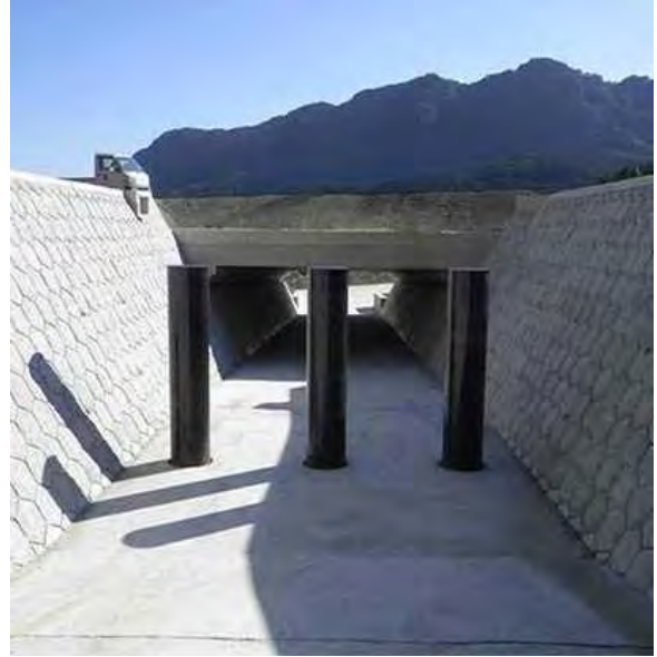
国)宮崎河川国道事務所 東九州道芳ノ元地区1工区 規模：高さ2.0m 幅5.0m 鋼管：φ-406.4×19
