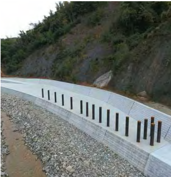
国) 筑後川河川事務所 赤谷川流木貯留施設 規模：高さ2.7m 幅38.5m 鋼管：φ-406.4×16
