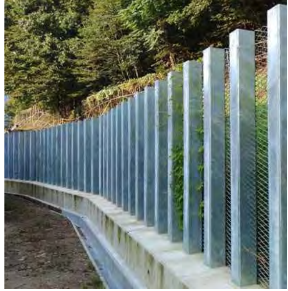
長野県 上田市 腰越地区落石対策工事 規模：高さ3.2m 幅140.0m 鋼管：□-200×6
