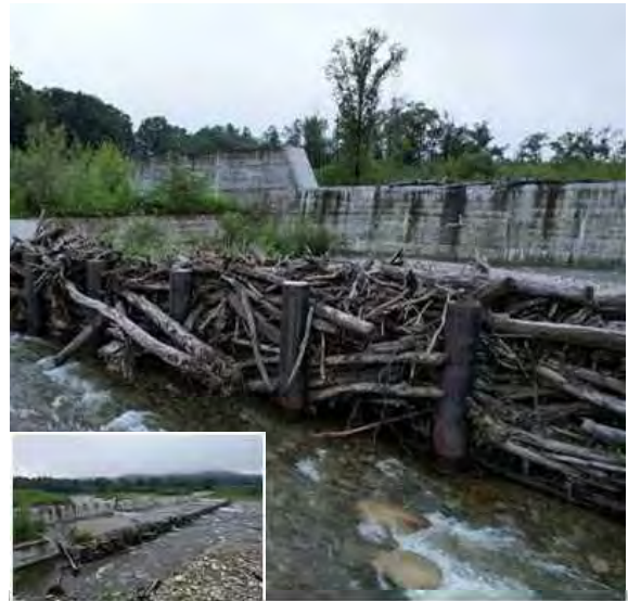
国)帯広開発建設部 戸蔦別川／規模：高さ3.0m、開口幅126m 2023年8月 天端まで捕捉(完成から2年後)
