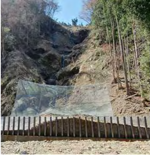
長野県 下伊那南部建設事務所 天龍村国道418号1工区 規模：高さ3.7m 幅50.0m 鋼管：□-200×6
