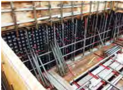
現場名：益城中学校 屋内運動場新築災害復旧工事 建設会社：新規建設株式会社 施工業者：株式会社鶴田工務店
