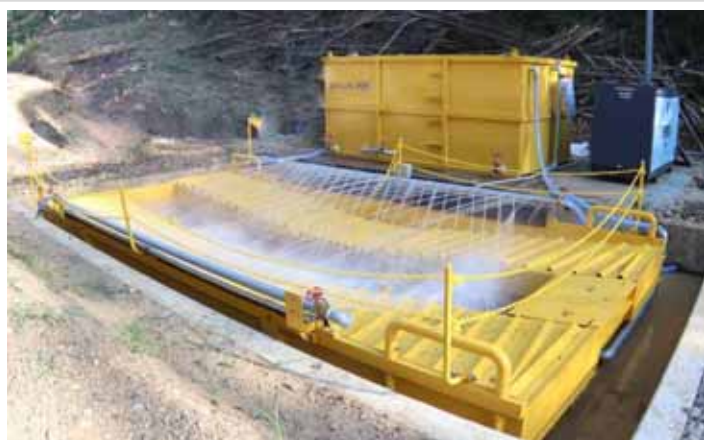
ピットに溜まった水をポンプでタンクに送り返し再利用
