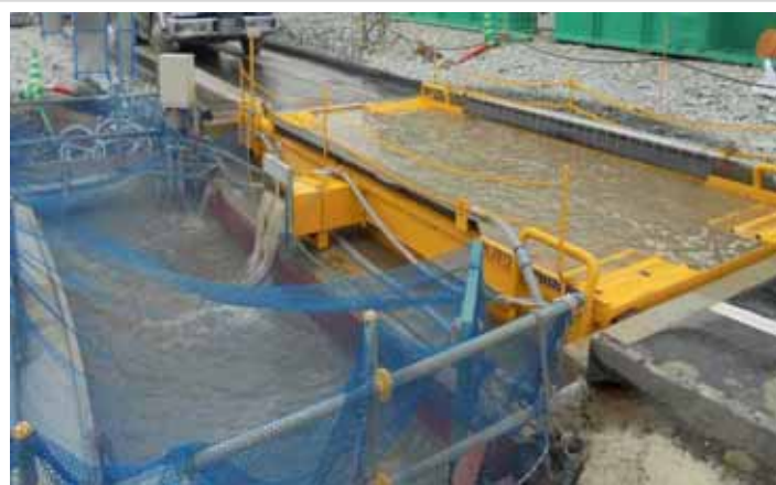
ピットに溜まった水を吐出口から埋設タンクへ自然排水し再利用する
