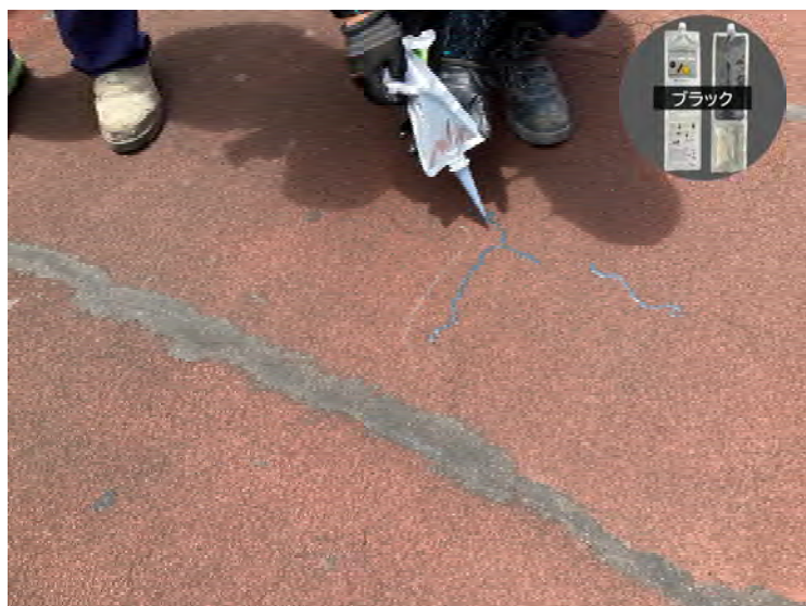
滑り止め舗装の剥がれ防止
