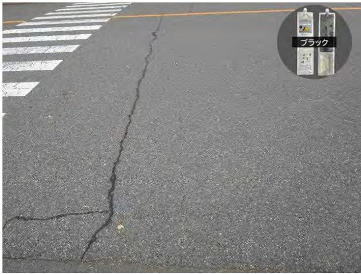
アスファルト舗装のクラック
