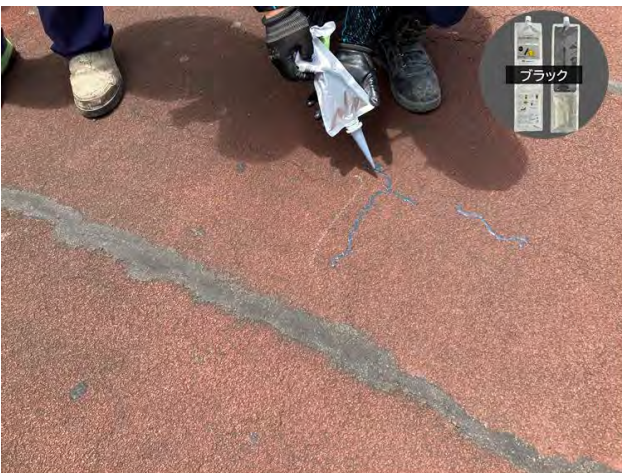
滑り止め舗装の剥がれ防止
