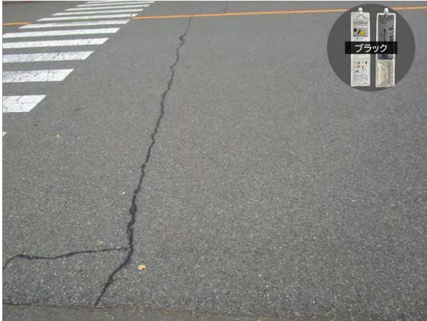
アスファルト舗装のクラック
