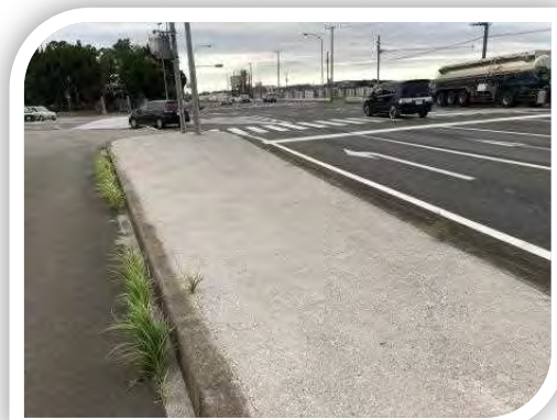
路肩部の防草例
