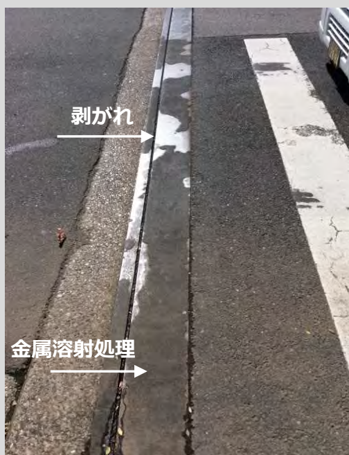
金属溶射表面処理の剥がれ
