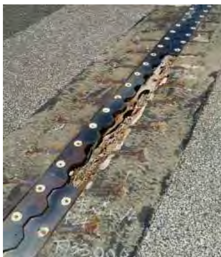
溶接部を起点に 疲労破断した伸縮装置
