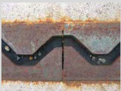
製品連結部からの漏水
