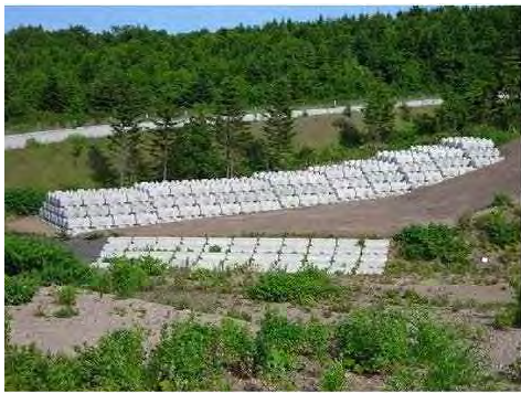
馬抛沢川砂溜工最下流部に設置したコンバリア(導流堤)
