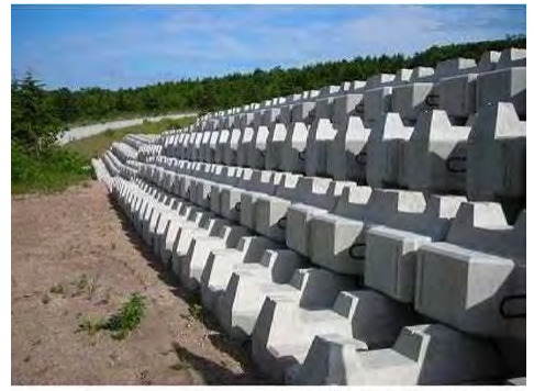
馬抛沢川砂溜工最下流部に設置したコンバリア(拡大)
