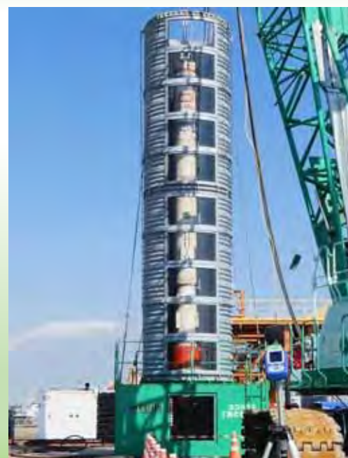
騒音防止装置の使用状況（千葉県袖ヶ浦）
