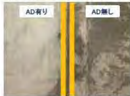
経年後のコンクリートの表面状況
