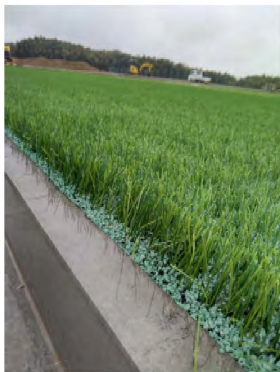
人工芝大手施工後一ヶ月流出中
