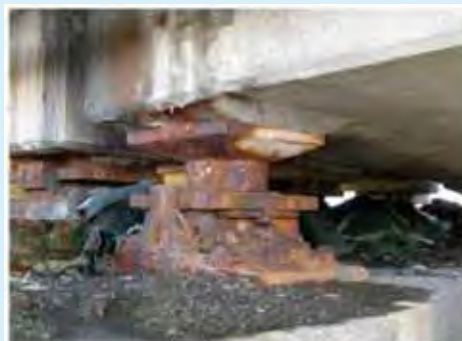
損傷例-② 遊間、地覆端部からの漏水
