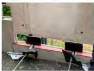
⑦ 上側壁面材の設置、固定 ⑧ 撤き出し、敷均し、締固め
