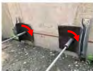
⑨ トルク鋼管の本締め ⑩ 壁面隙の充填（以降通常施工と同様）
