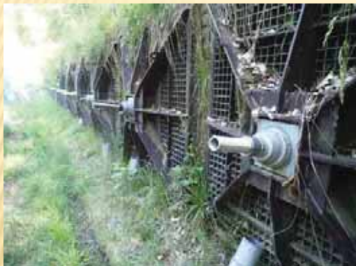
施工後 3年経過したアンカーの状況 (グリスを用いず腐食なし)
