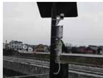
ソーラー発電型水位観測システム
