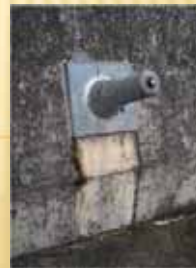
背面水の作用した痕跡
