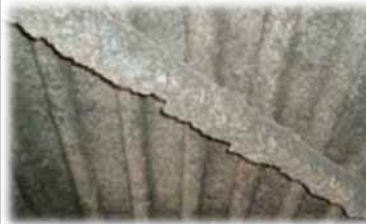
石綿含有吹付けロックウール
