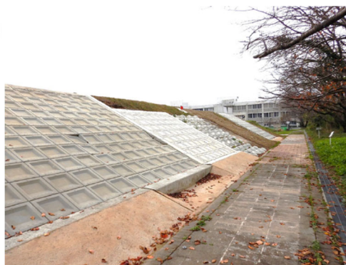
▲護岸基礎部の洗掘
