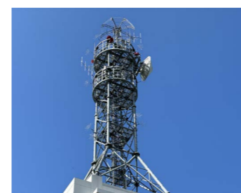
パラボリアンテナ 災害に強いマイクロ波により、各事務所・観測所とのデータ伝送を行う
