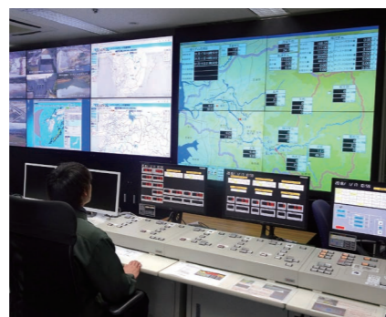
ダムゲートの遠方操作
