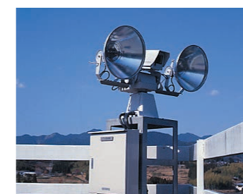
CCTVカメラ 計26台のカメラが、ダム堤体や周辺の状態を映し出し監視する
