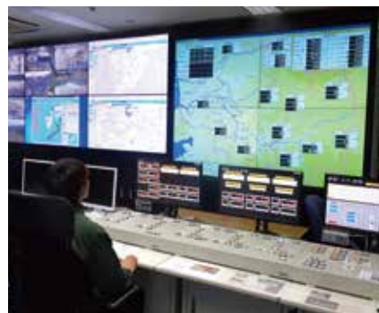
ダムゲートの遠隔操作
