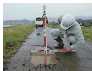
○堤防天端の不陸による水たまり
