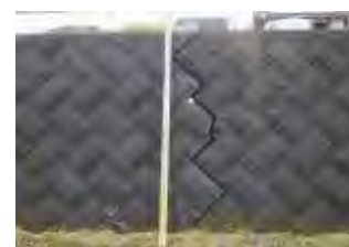
○老朽化した堤防護岸
