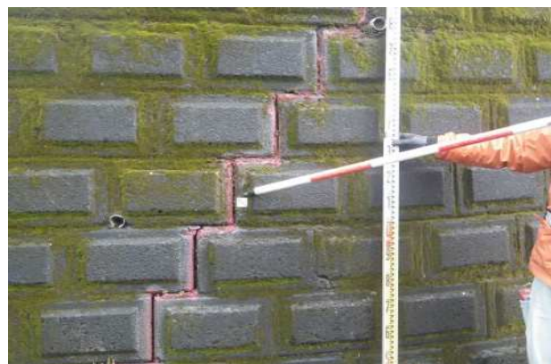
写真 2.1.3 堤防護岸の老朽化による亀裂
