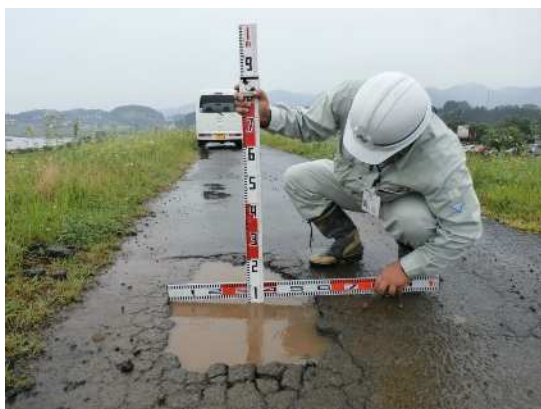
写真 2.1.2 堤防天端の不陸による水たまり
