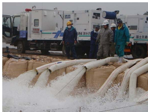
写真 4-3-7 国土交通省が保有する 排水ポンプ車
