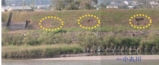
○ 堤防法面の被災状況 (平成 17 年 9 月洪水)
