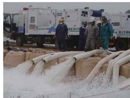
○宮崎河川国道事務所で保有する排水ポンプ車 (東日本大震災支援活動状況)
