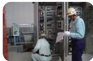
○電気設備の点検状況
