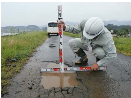
写真 2.1.2 堤防天端の不陸による水たまり
