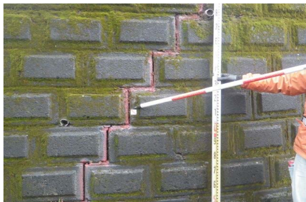
写真 2.1.3 堤防護岸の老朽化による亀裂
