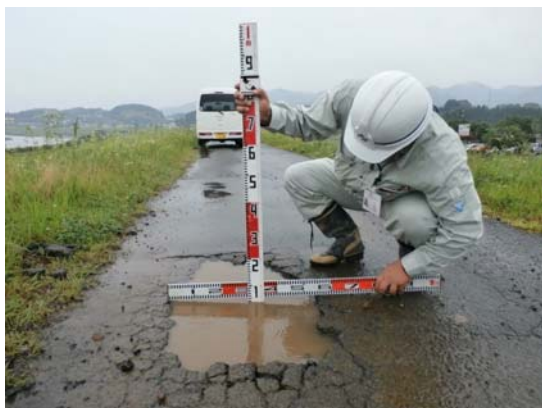
写真 2.1.2 堤防天端の不陸による水たまり
