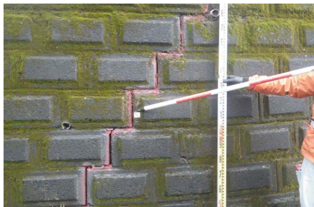
写真 2.1.3 堤防護岸の老朽化による亀裂
