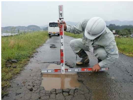
写真 2.1.2 堤防天端の不陸による水たまり
