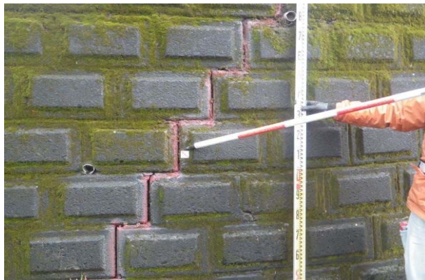
写真 2.1.3 堤防護岸の老朽化による亀裂
