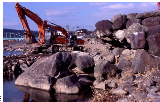
写真-14 急流河道に設置された胴部を長く頭部を高くした高水水制の崩落した先端部
